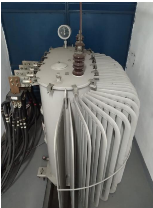
Figura 10: Transformador a óleo
