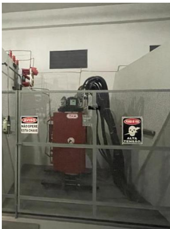
Figura 9: Transformador a seco
