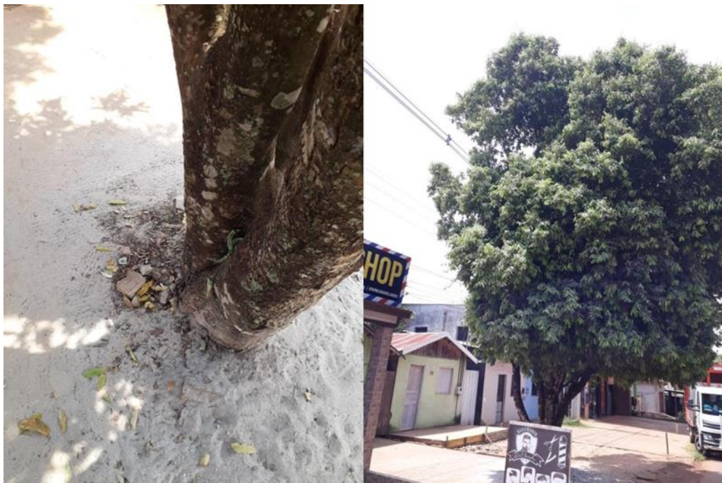
Figura 4 – Base pavimentada e presença de fiação.
