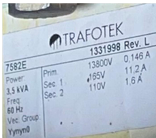
Figura 15 - Dados do transformador de excitação.
