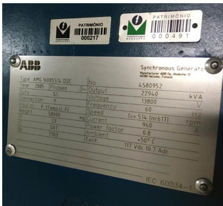
Figura 13 - Placa do gerador.
