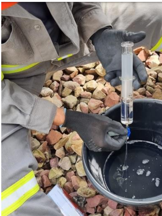
Figura 36 – Manutenção: Coleta de óleo para análises
