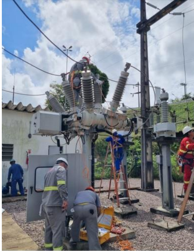
Figura 30 – Manutenção: Disjuntor 69 kV - Módulo PASS
