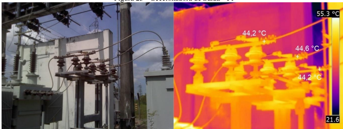
Figura 25 – Seccionadora de Saída –T1
