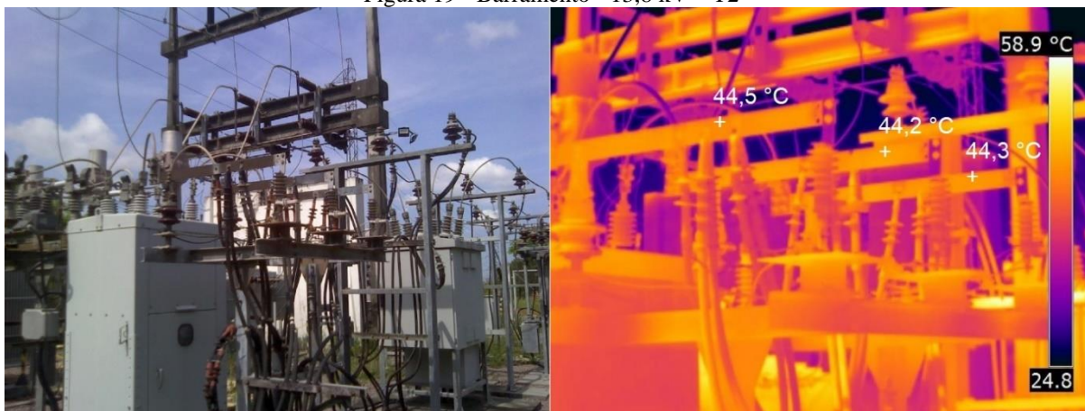
Figura 19 - Barramento - 13,8 kV – T2
