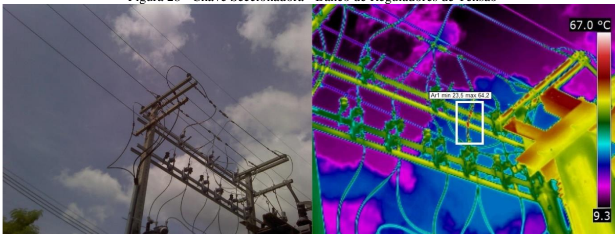
Figura 28 - Chave Seccionadora - Banco de Reguladores de Tensão
