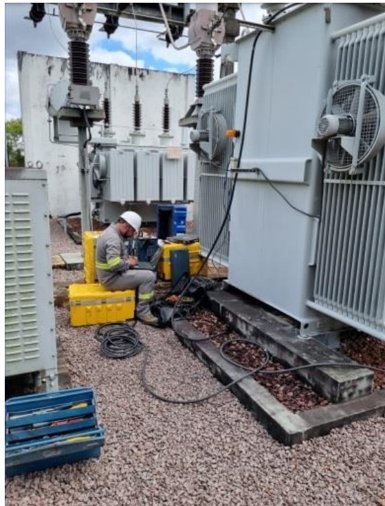
Figura 33 – Manutenção Transformador T2
