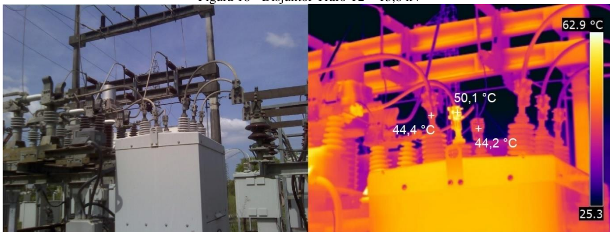
Figura 18 - Disjuntor Trafo T2 – 13,8 kV
