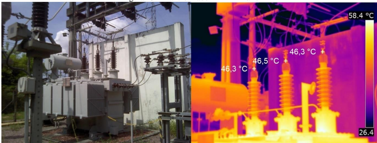
Figura 23 - Transformador T1 - Primário
