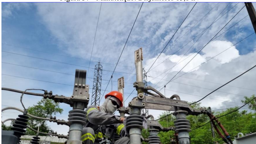
Figura 37 - Manutenção: Disjuntores 13,8 kV
