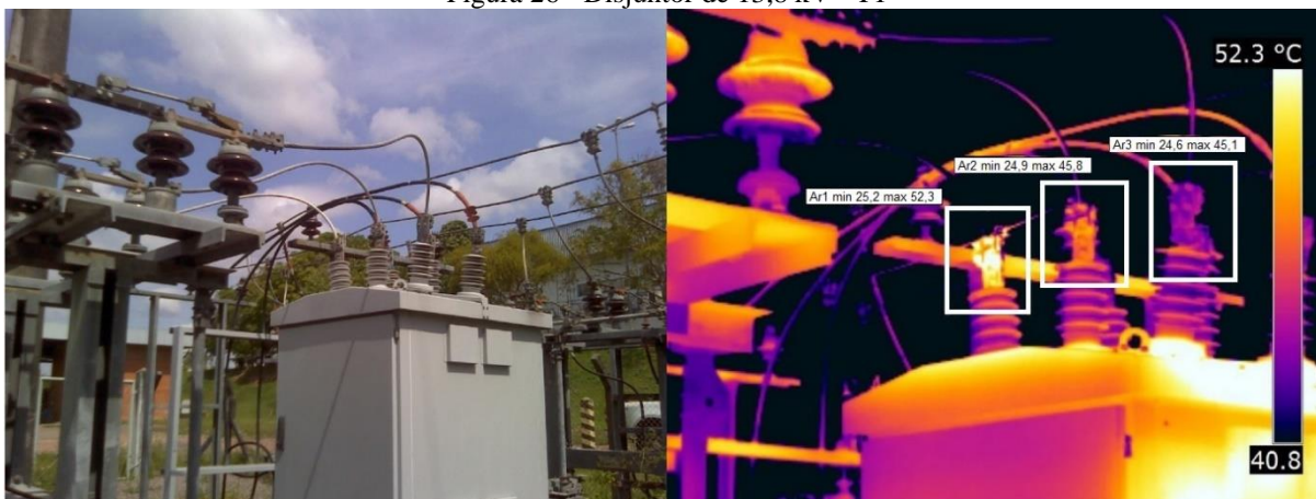
Figura 26 - Disjuntor de 13,8 kV - T1
