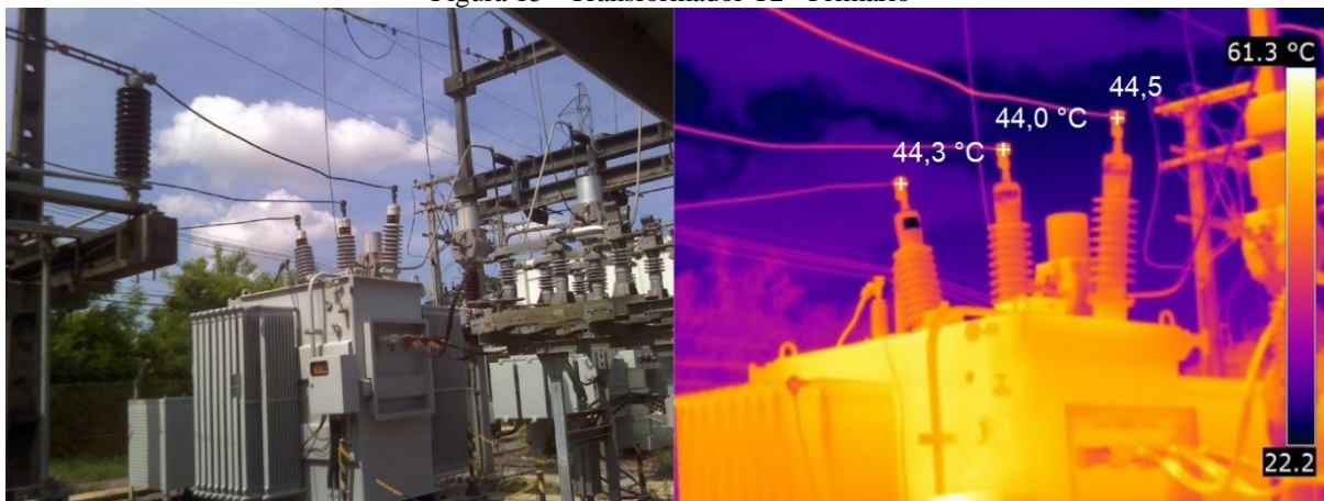
Figura 15 - Transformador T2 - Primário
