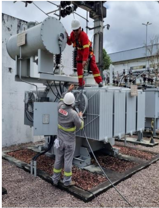
Figura 34 - Manutenção: Trafo T1
