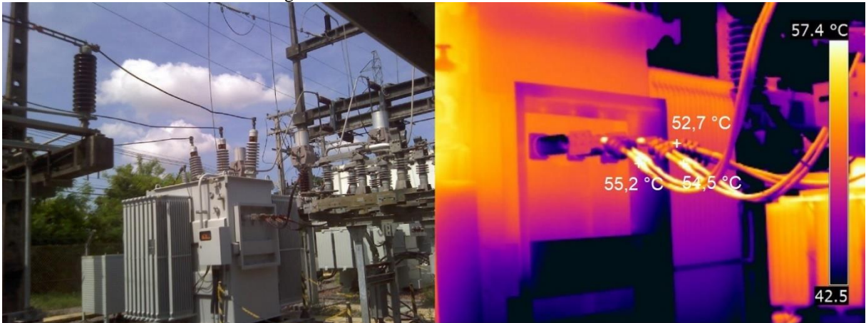
Figura 16 - Transformador T2 - Secundário
