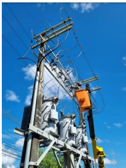
Figura 38 - Manutenção: Reguladores de Tensão
