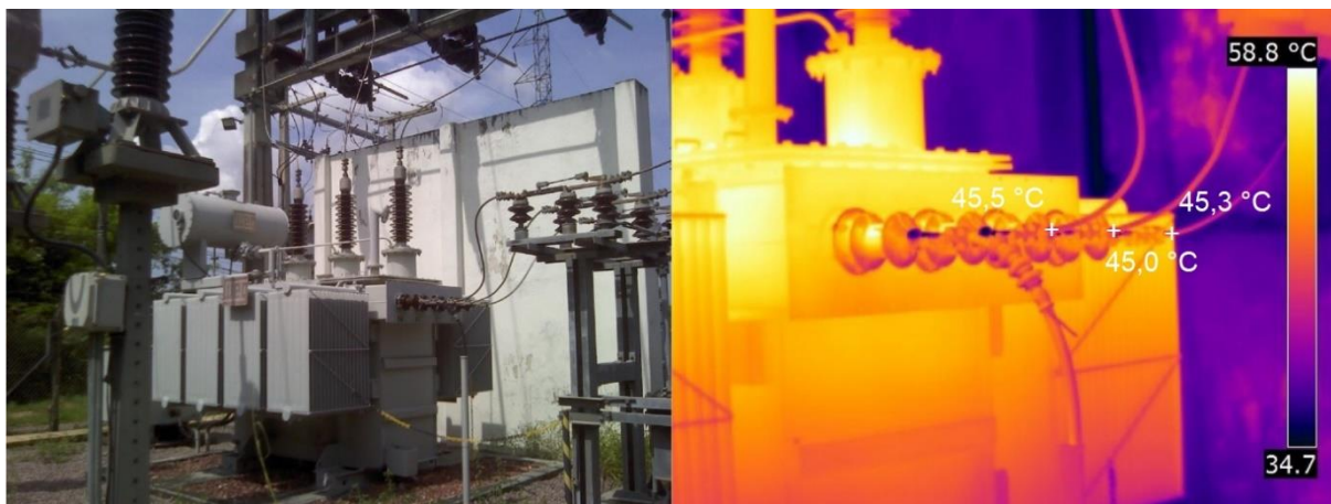
Figura 24 - Transformador T1 - Secundário
