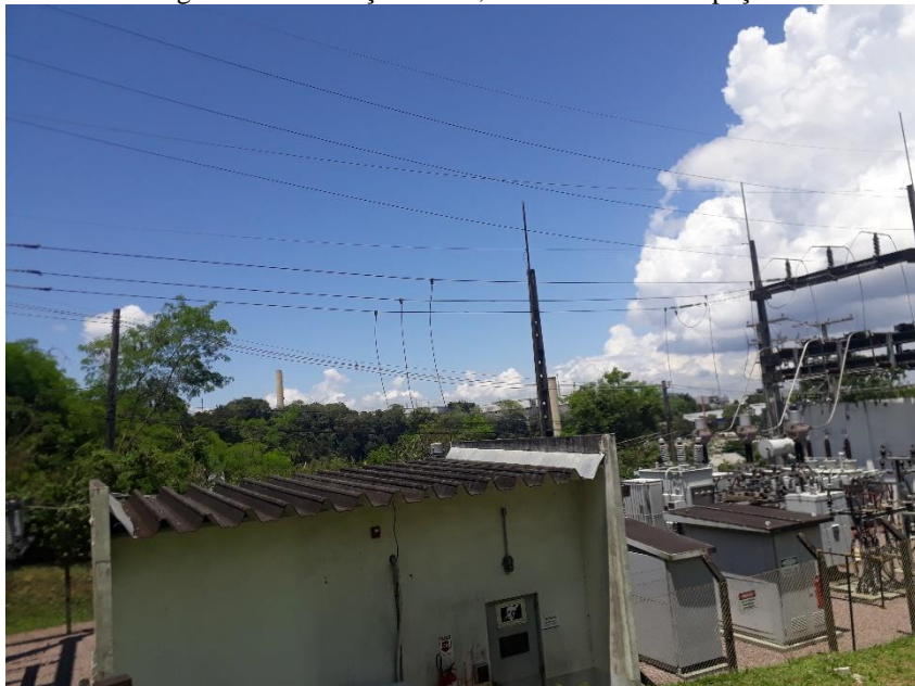
Figura 6 - Subestação 69/13,8 kV – Local da inspeção
