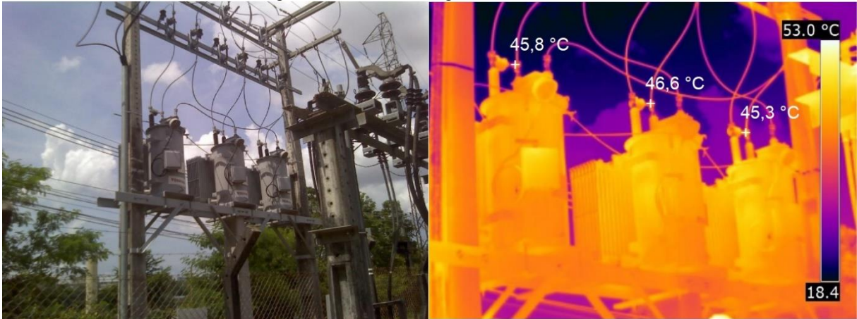
Figura 27 - Banco de Reguladores de Tensão
