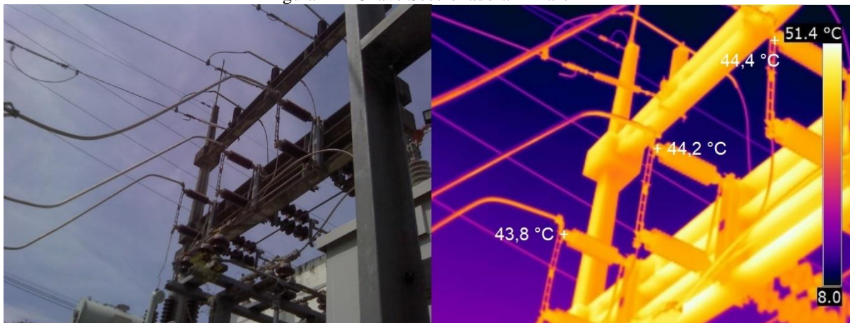
Figura 22 - Chave Seccionadora – Trafo T1
