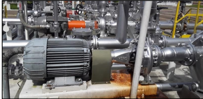
Figura 9: Bomba centrífuga em estudo
