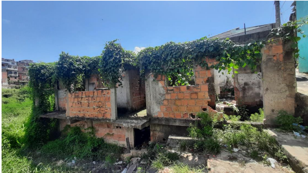
FIGURA 9: CASA ABANDONADA APÓS O INCÊNDIO DE 2018.
