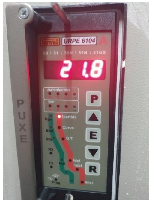
Figura 11 – Relé de proteção secundária PEXTRON URPE 6104.
