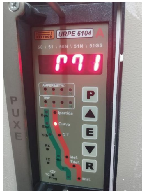
Figura 15 – Relé de proteção secundária PEXTRON UPER 6104.
