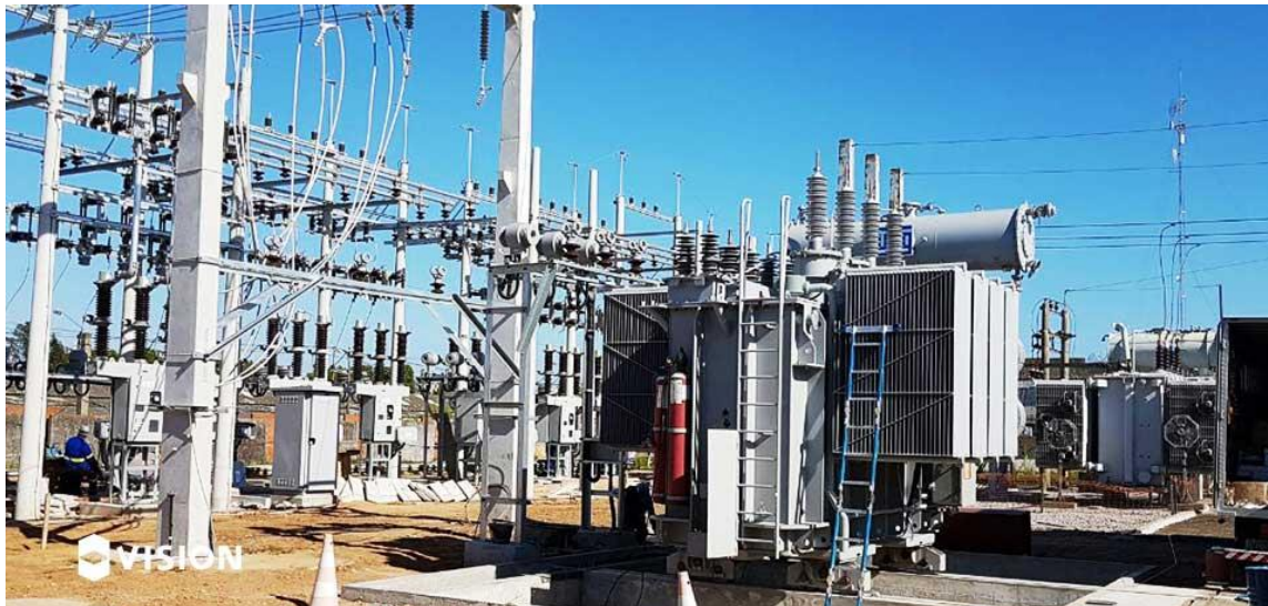
Figura 1 – Subestação de Rio Grande 2 com capacidade de 50 MVA.
