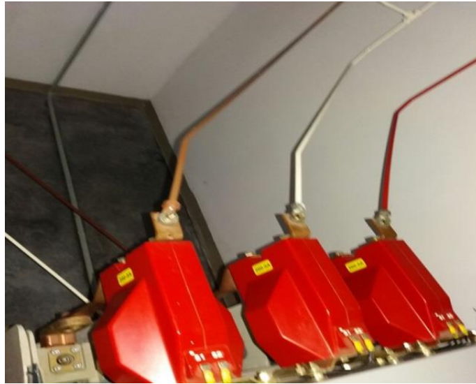
Figura 7 – Transformadores de corrente de 15 kV com relação 350/ 5 A (TC).
