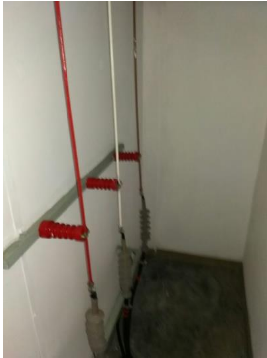
Figura 4 – Muflas poliméricas de 15 kV do tipo externo (Super Terminais).
