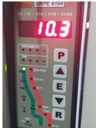
Figura 43 - Parâmetro de Neutro encontrado na subestação da UEA- REITORIA
