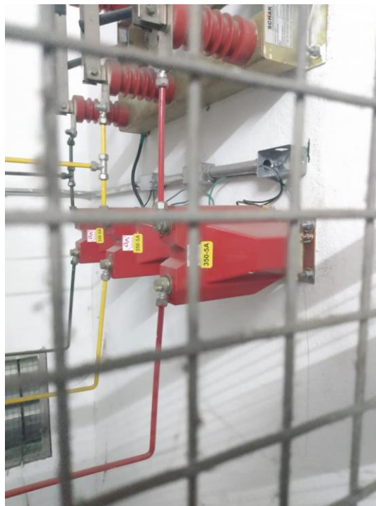
Figura 14 – Transformador de Corrente 10B100 350/5 A.
