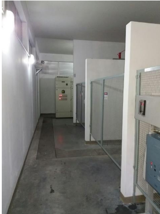
Figura 3 – Subestação da Super Terminais de média tensão (13,8kV) e seus cubículos
