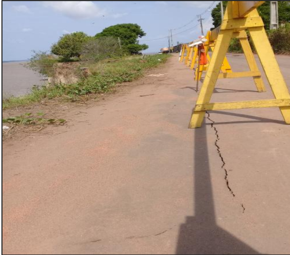
Figura 5: Situação da Rua Portugal em 23/11/2018.
