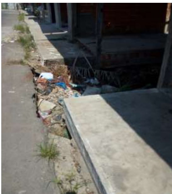
Imagem 04: Depressão na calçada.
