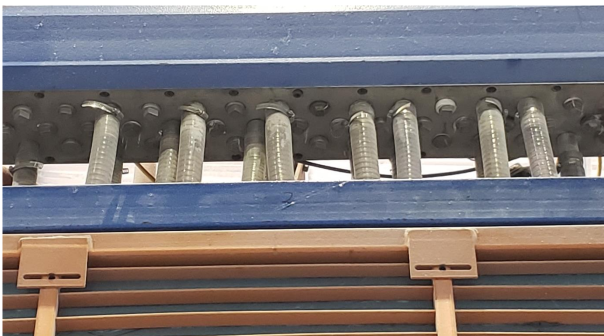
Fig.15: Mangueiras de alimentação de matéria prima fixadas com abraçadeiras metálicas
