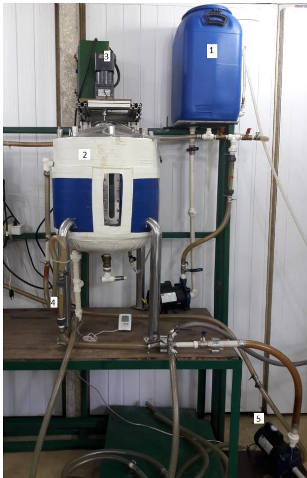
Figura 8 - Instalação experimental do trocador de calor encamisado com agitação.
