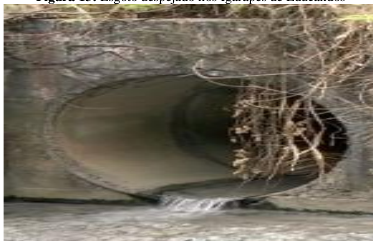
Figura 13: Esgoto despejado nos Igarapés de Educandos
