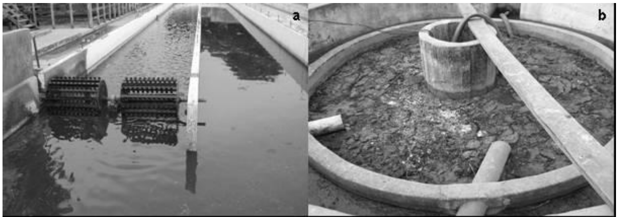
Figura 2.a: sistema arejado de tratamento de efluentes líquidos
