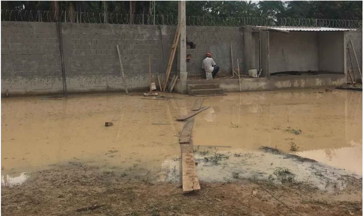
Figura 20 Acúmulo De Água/Lama No Terreno Devido A Inclinação Do Relevo
