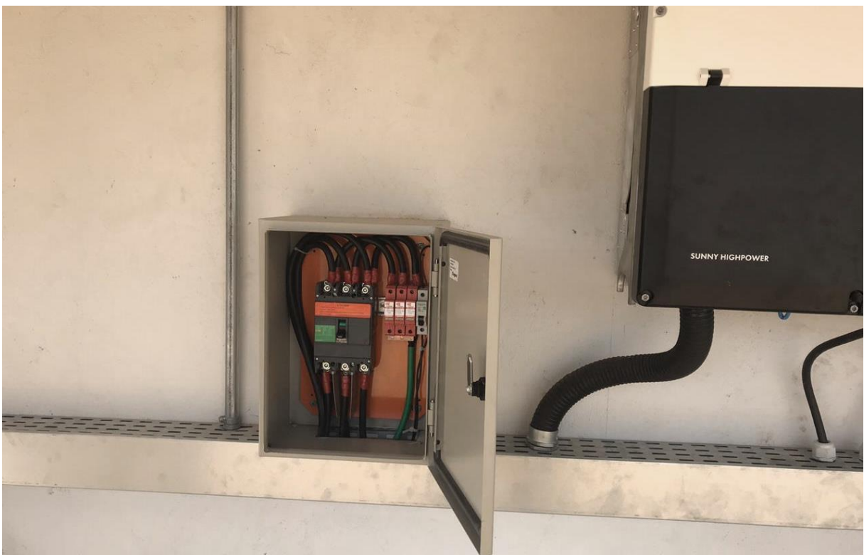
Figura 27 Proteção AC Do Sistema Solar Fotovoltaico
