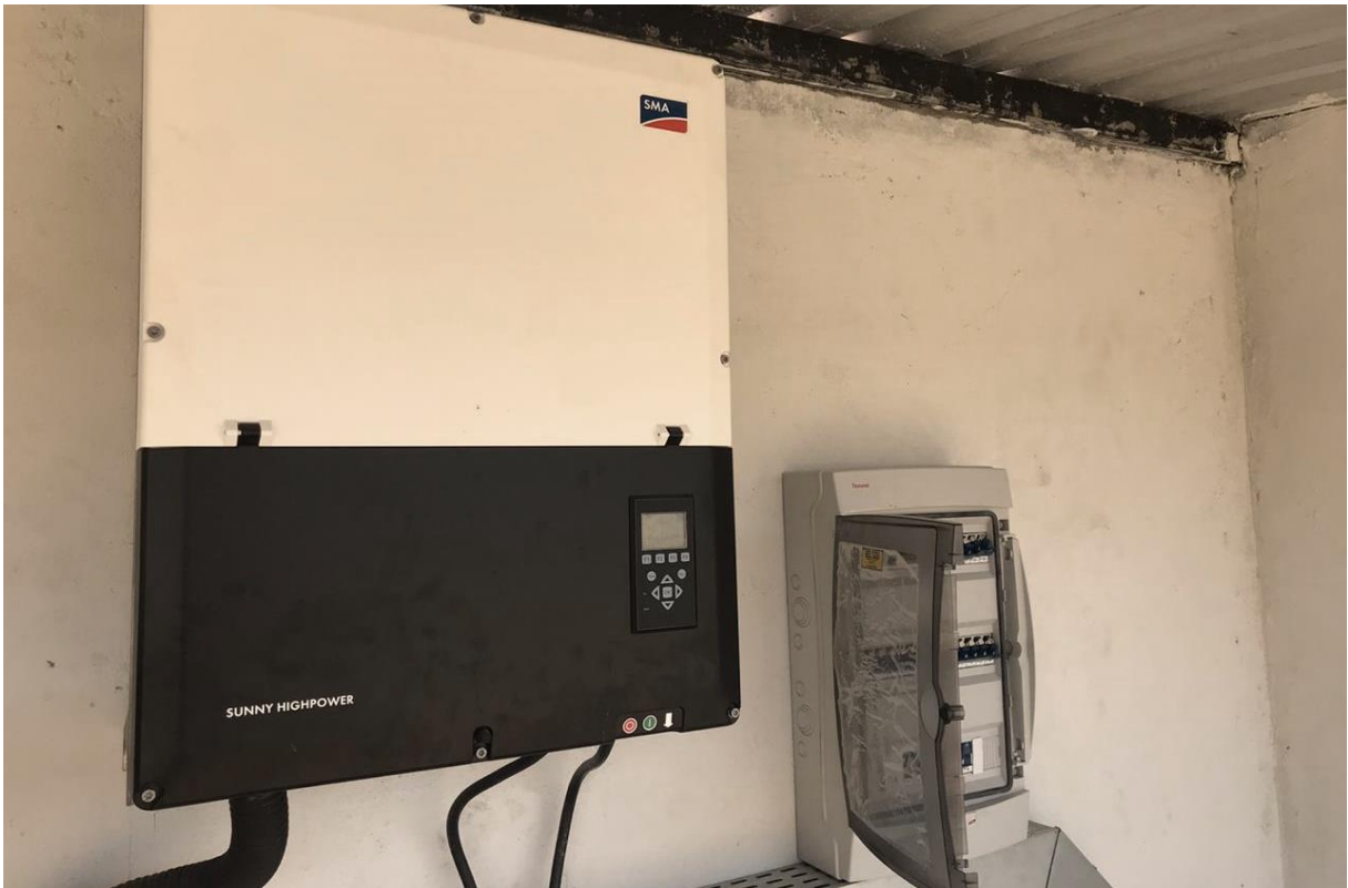
Figura 26 Equipamento De Conversão DC/AC E Proteção DC Do Sistema Solar Fotovoltaico
