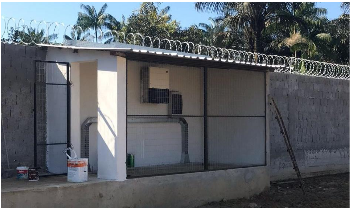
Figura 25 Detalhes Do Abrigo Destinados Aos Equipamentos Do Sistema Solar Fotovoltaico
