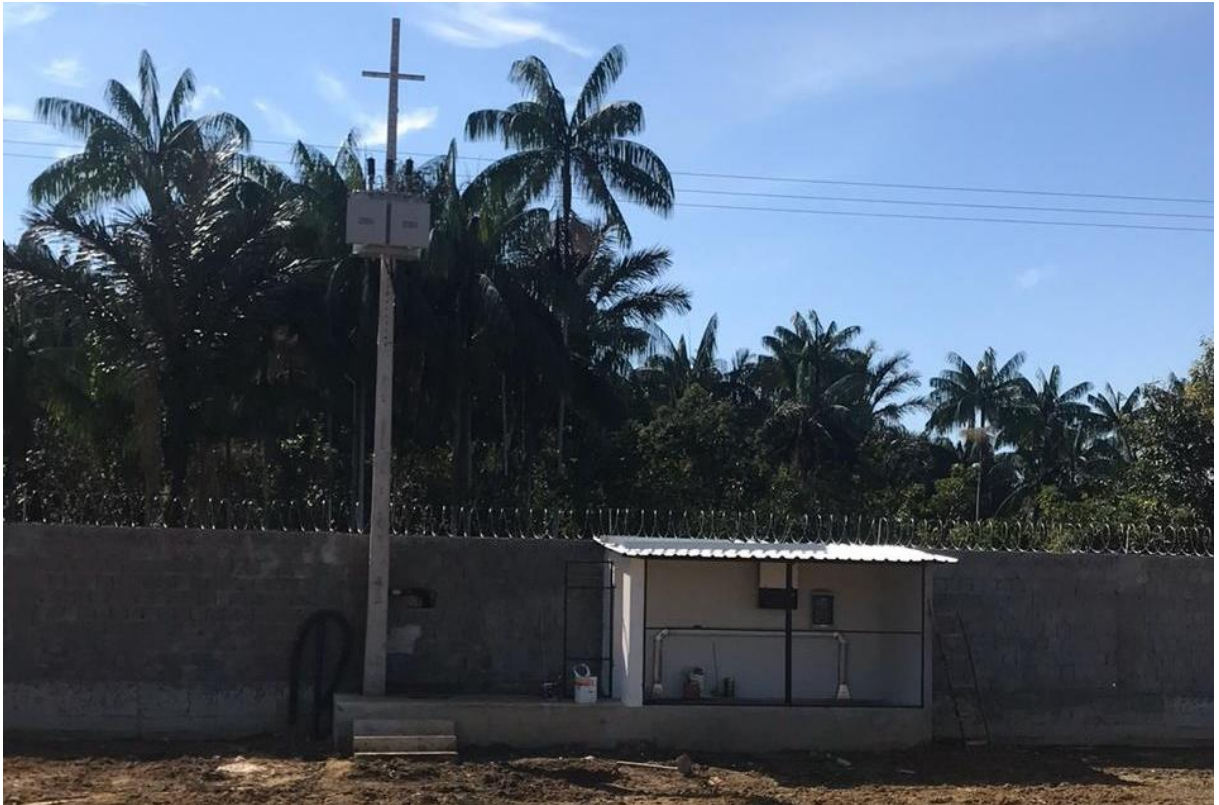
Figura 24 Posicionamento Da Subestação Aérea E Do Abrigo Destinados Aos Equipamentos Do Sistema Solar Fotovoltaico
