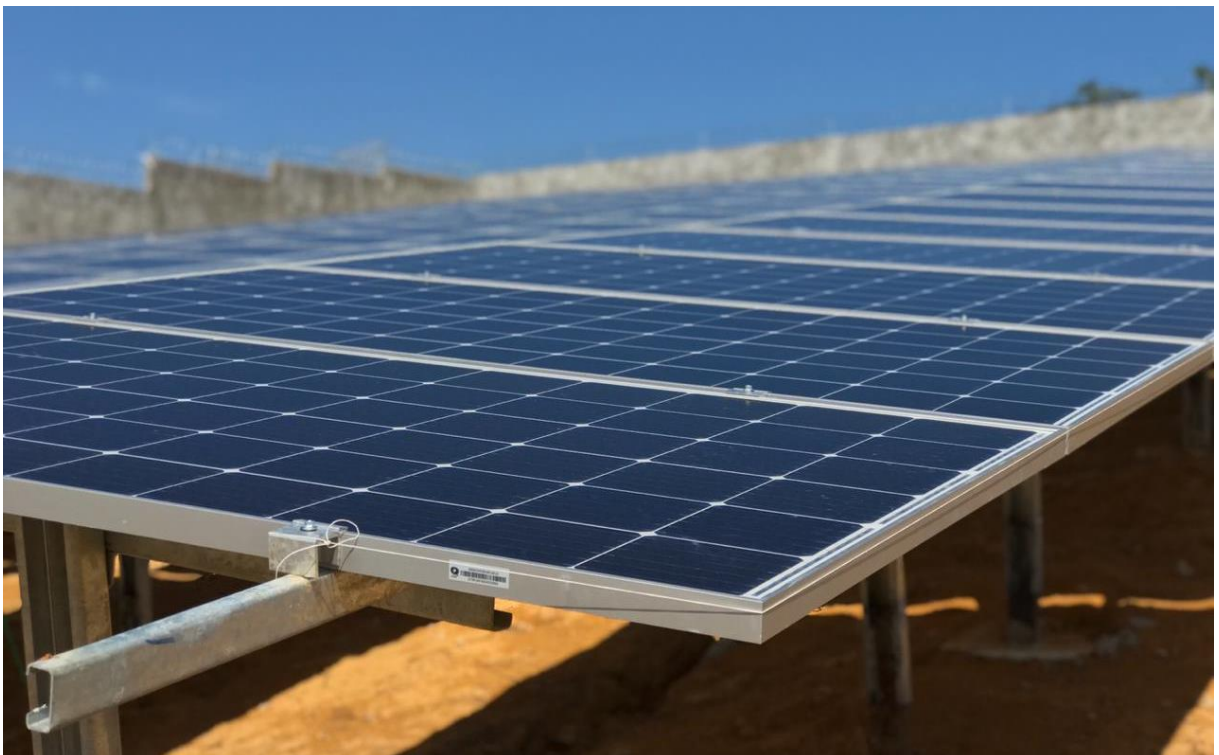
Figura 23 Detalhes da Fixação dos Módulos Solares
