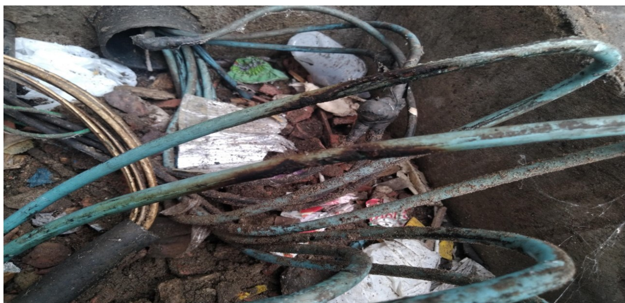
Figura 16 - Cabos saindo da subestação: ressecados, ruídos e já apresentando sinais de que princípio de incêndio
