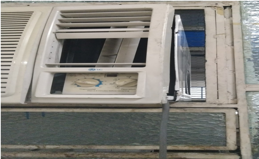
Figura 18 - Isolação de uma instalação do ar-condicionado
