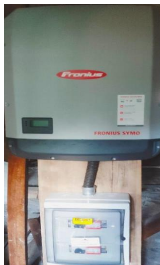
Figura 21 – String box e Inversor instalados
