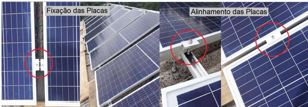
Figura 15 – Presilha de fixação e alinhamento dos painéis fotovoltaicos no trilho de sustentação
