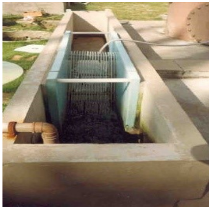
Figura 8 - Grades para o tratamento preliminar
