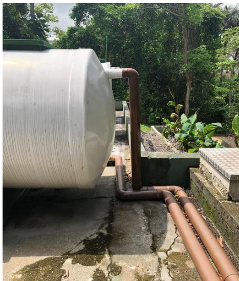
Figura 11. Saída do tanque para armazenamento da água tratada.
