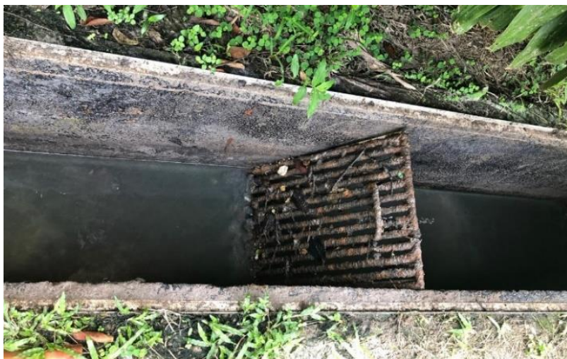
Figura 7. Sistema de gradeamento da ETE.
