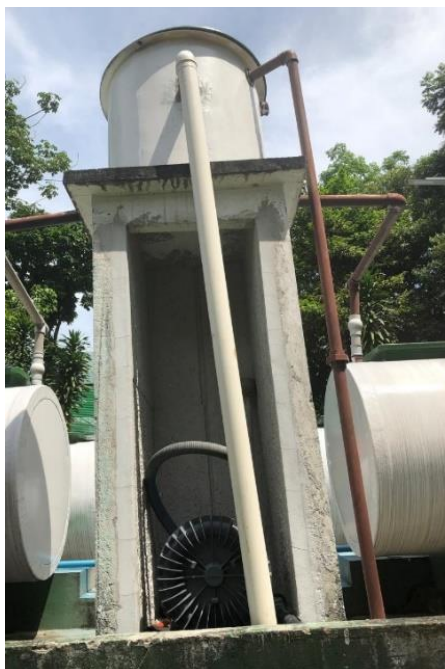
Figura 8. Bombeamento para os tanques de Aeração (sistema secundário).
