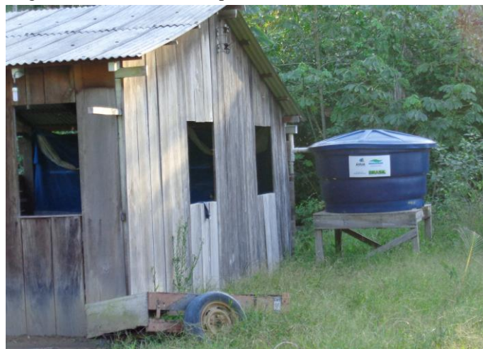
Figura 22: Reservatório de polietileno – APT/AM
