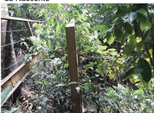
Figura 24 – Ponte desativada da Trilha da Nascente
