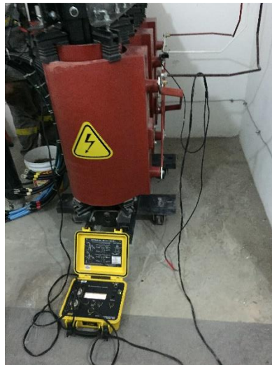
Figura 4: Ensaio de medição da relação de espiras do transformador
