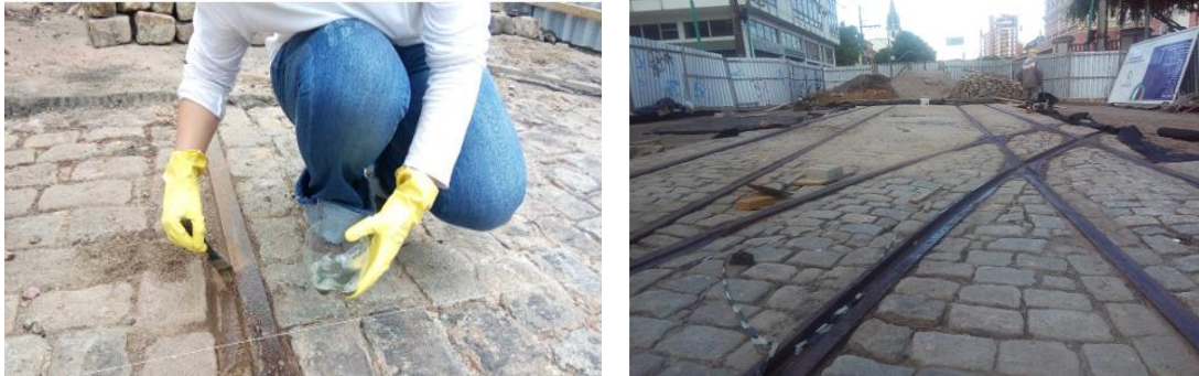
Fig.32 e 33 trilhos durante a aplicação do QUIMOX e após a aplicação do P.C.F.
